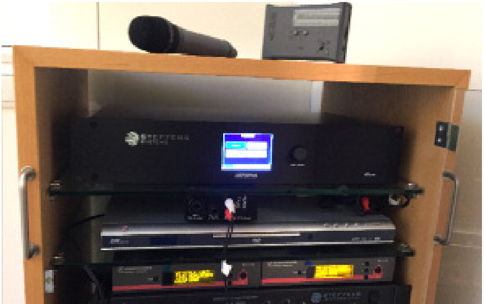
Das Wunderwerk für die Lautsprecheranlage in der Sakristei.
